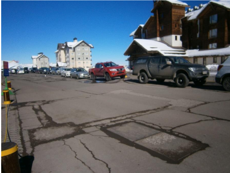
Imagen 46: Estado actual de Vialidad en Valle Nevado, 30.05.2017. Fuente: Asesoría Urbana.
