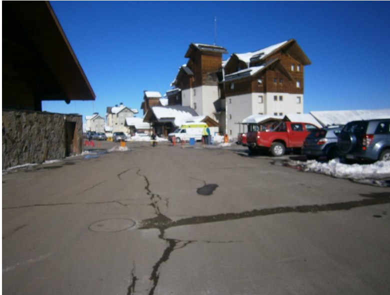
Imagen 50: Estado Actual de Vialidad en Valle Nevado, 30.05.2017. Fuente: Asesoría Urbana.
