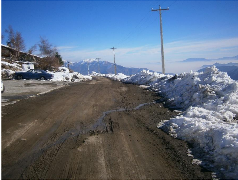
Imagen 40: Estado Actual de Vialidad en El Colorado, 30.05.2017.Fuente: Asesoría Urbana.
