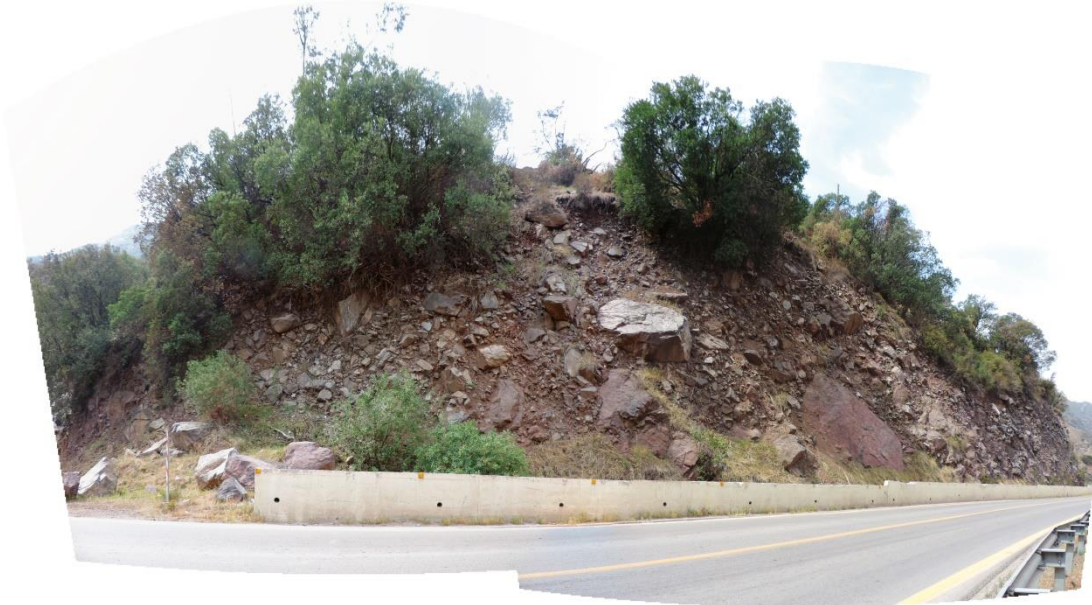
Figura Apéndice C—8 Vista en corte de los depósitos antiguos de remociones en masa en el kilómetro 10 del Camino a Farellones. Es posible distinguir bloques métricos polimícticos embebidos en un arreglo caótico de rocas fragmentadas y angulosas de granulometrías diversas.
