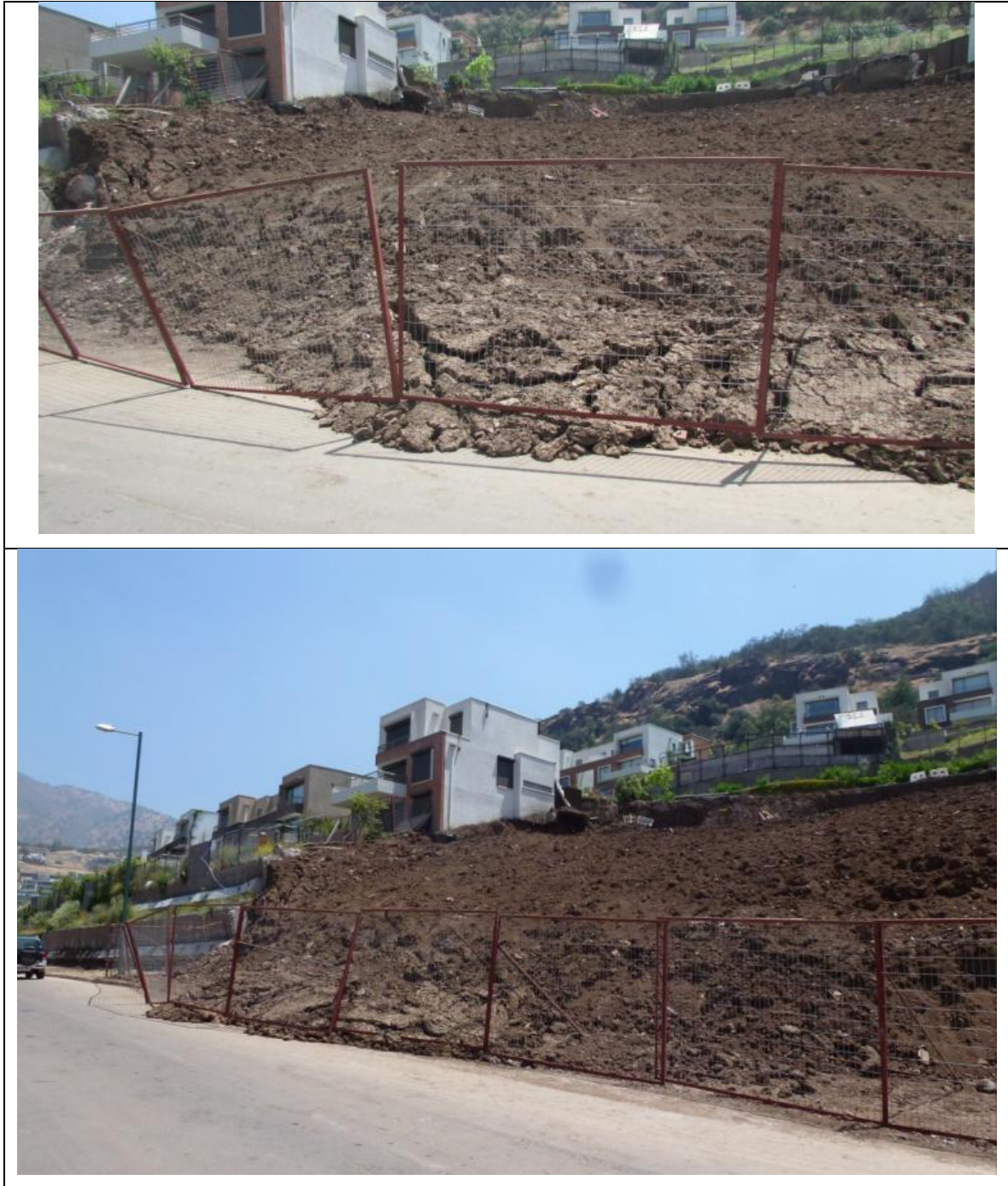
FIGURA N° 4-9 Vista del deslizamiento en Camino Punta de Águilas, donde se observan evidencias de movimientos posteriores a la demolición de la vivienda afectada.
